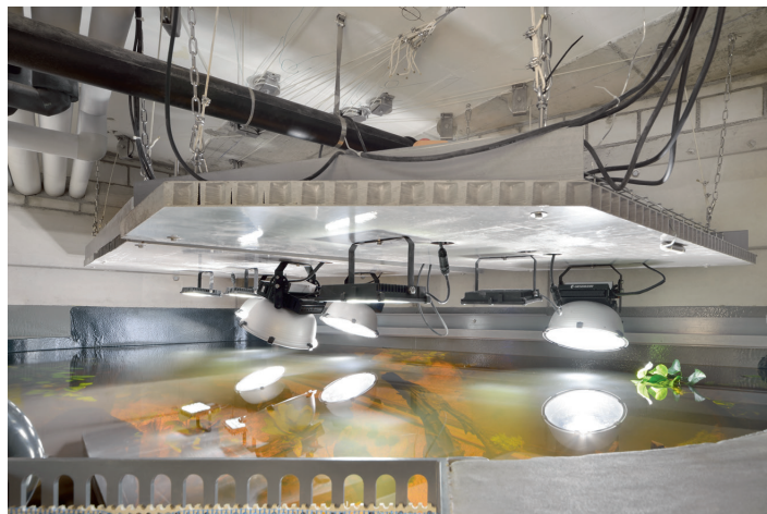
Die GFK-Roste mit den Beleuchtungen können motorisiert über verschiedene Seilzüge in der Höhe reguliert werden.
